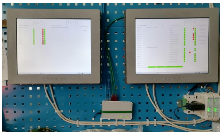
Рис. 6. Рабочее место дежурного в комнате 201/1. На фотографии два монитора: справа монитор элементов магнитной оптики в зале 205 корпуса, слева — элементы в старом измерительном павильоне
